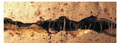
Stålfiberarmeret beton er en af de teknologier, som Teknologisk Institut har stor tiltro til. Et forskningsprojekt har leveret dokumentation og beregningsmetoder for teknologien, hvis perspektiv er at erstatte en del af den slappe armering. Foreløbig bruges stålfiberarmering dog kun til at mindske svindrevner. (Foto: Teknologisk Institut)
