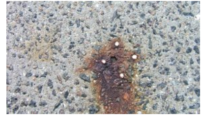
Trods årtiers arbejde med beton begår vi stadig fej – eksempelvis kan de afstandsklodser, der holder armeringen væk fra betonoverfladen, skrumpe en smule, så der kan trænge salt ind til armeringen gennem hulrummet. (Foto: Teknologisk Institut)
