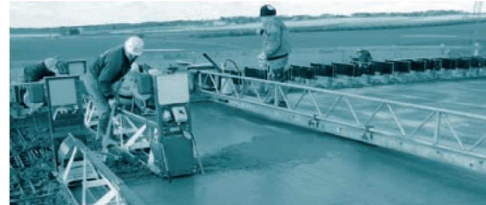
Afretning af brodæk på Bro 34. Brodækket blev udstøbt med tre forskellige betontyper.
