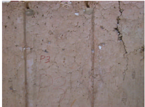
Figur 4.14. Foto af brandpåvirkede vægelement med betontype P3.
