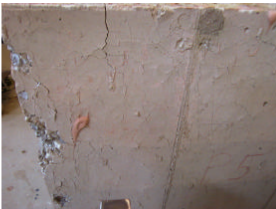
Figur 4.15. Foto af brandpåvirket overflade af vægelement P5 med betontype P5.
